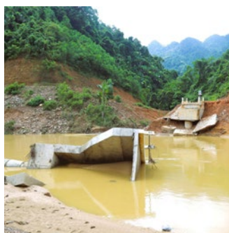
Hình 3. Cầu qua suối bị lũ phá hỏng, gây gián đoạn kết nối khu vực
