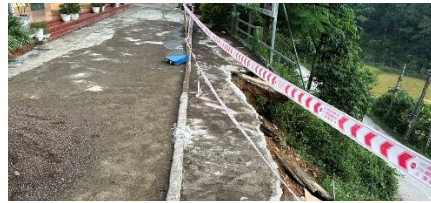
Hình 1. Trượt và nứt mặt nền trường tiểu học Ca Thành
